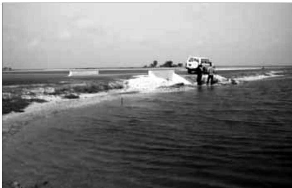
Pont de Palmarin. En 1979, la construction de la route avait bouché le bolon de Pandaka, entraînant un appauvrissement de la biodiversité et une érosion côtière. La construction du pont a permis de rétablir ces flux et d'atténuer les impacts de la route (Photo: Kane).
