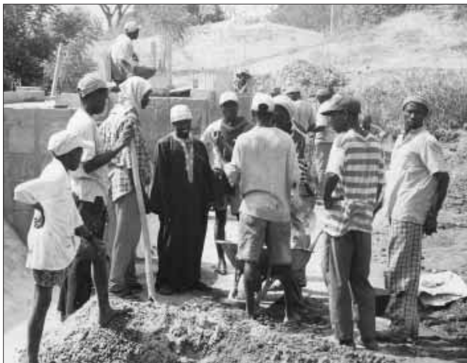
Le travail d'étude et de formulation doit s'accompagner de réalisations concrètes pour motiver les populations. Celles-ci construisent ici un barrage anti-sel à Nemaba (Photo: Mboj).
