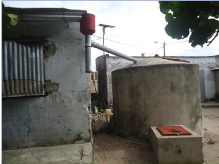
Photo 2 : Dispositif de collecte d'eaux pluviales au niveau de Falia (Source : DAMCP, 2013)
